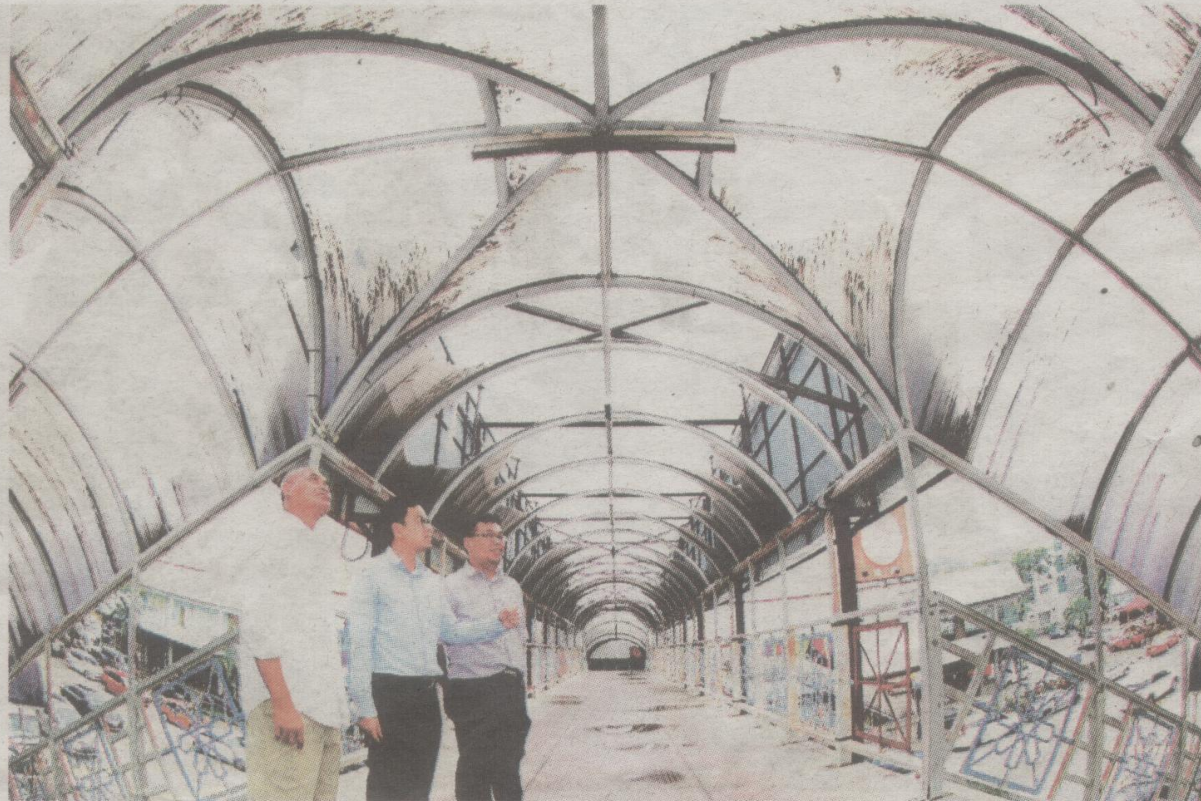
Chean Chung (tengah) dan Yew Lin (kanan) meninjau keadaan jejantas yang uzur dan usang di Jalan Tun Ismail.
