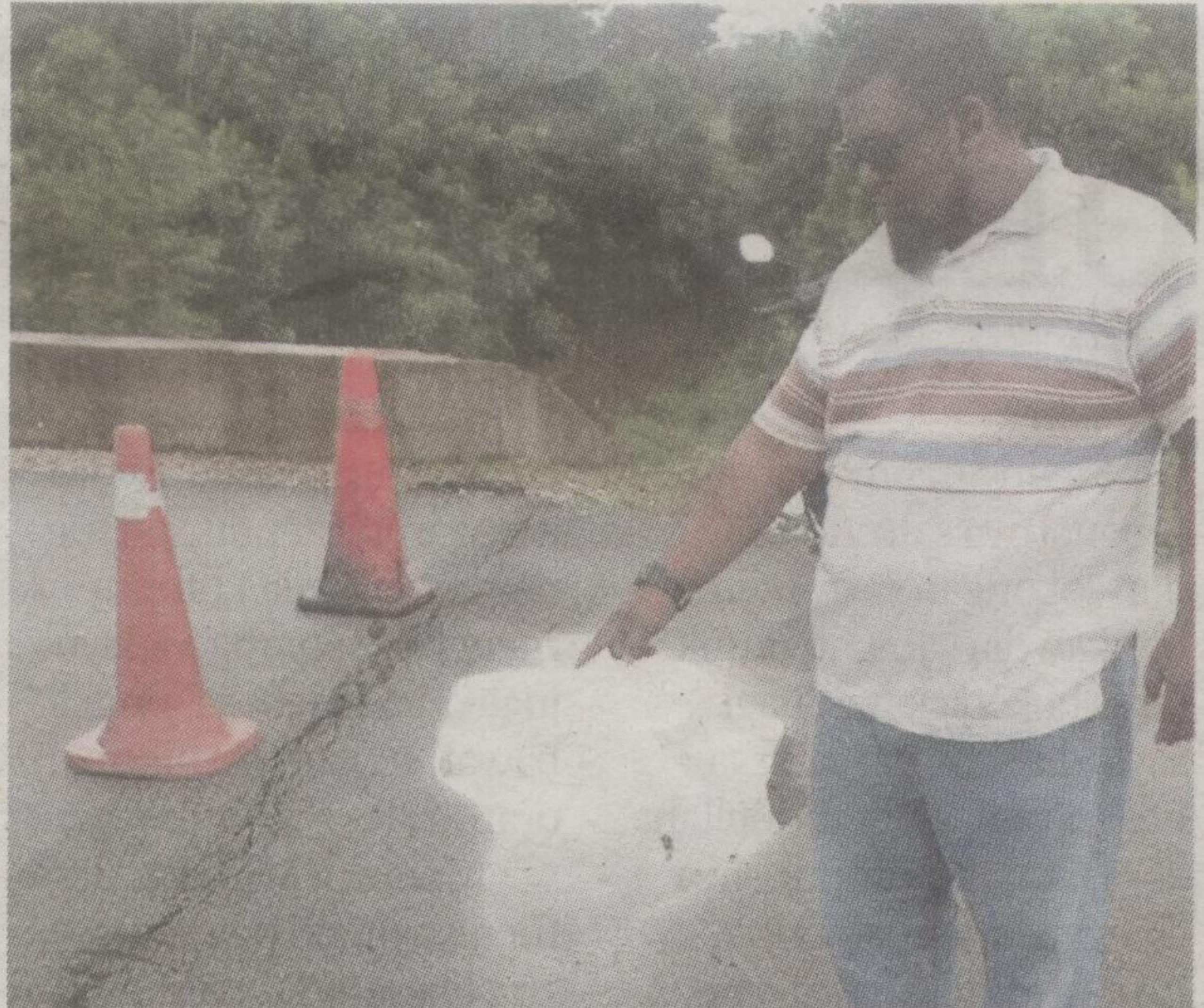
Penduduk, Zakaria Man, melihat lubang yang terbentuk di jalan Taman Perumahan Bukit Rangin 2.
